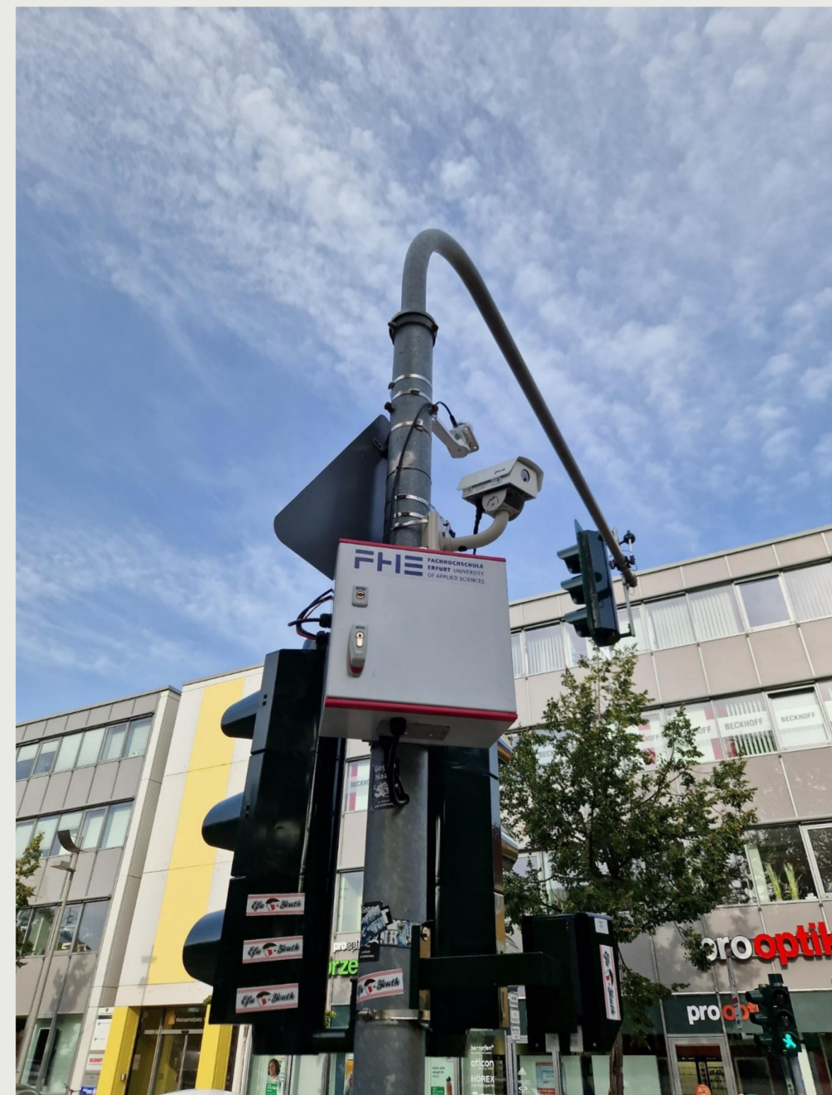
Abb. 3: Installierte Sensorik an einer LSA
